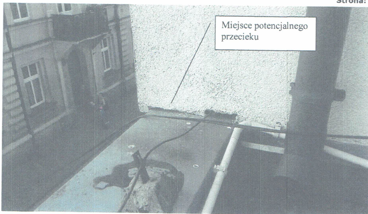
Fot. nr 6 miejsce potencjalnych przecieków (błędnie wykonana instalacja odgromowa „znikająca” pod ociepleniem elewacji)
