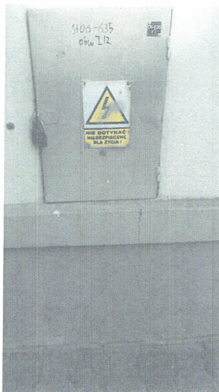
Fot. nr 2 zarysowania cokołu
