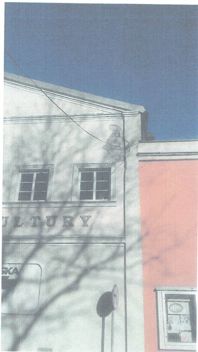
Fot. nr 1 skutny fragment luznego tynku w miejscu zarysowania.
